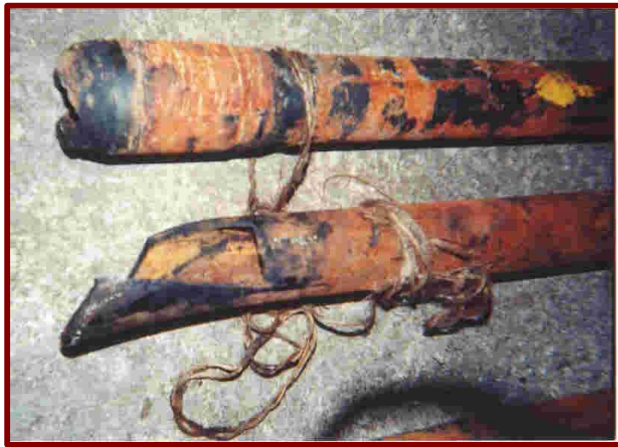
Figura 36 "Corrosión por ácido sulfhídrico"
